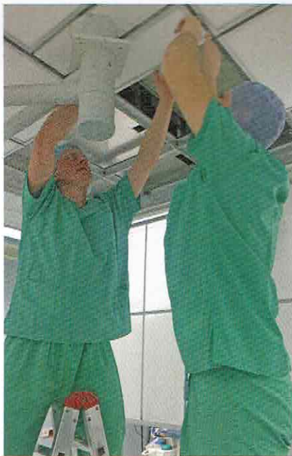
Anpackend: Norbert Gregor (l.) hat erst mal mit dem Serviceteam Filter unter OP-Decken montiert
